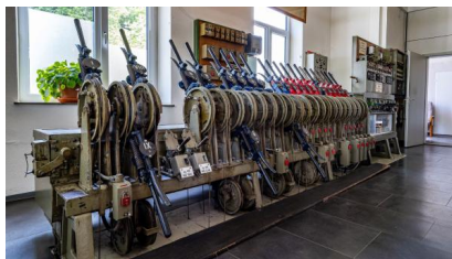
Blick auf die Stellwerkstechnik im Stellwerk Altshausen (Mai 2022) [Quelle: DB Netz AG/Thomas Ludwig]
