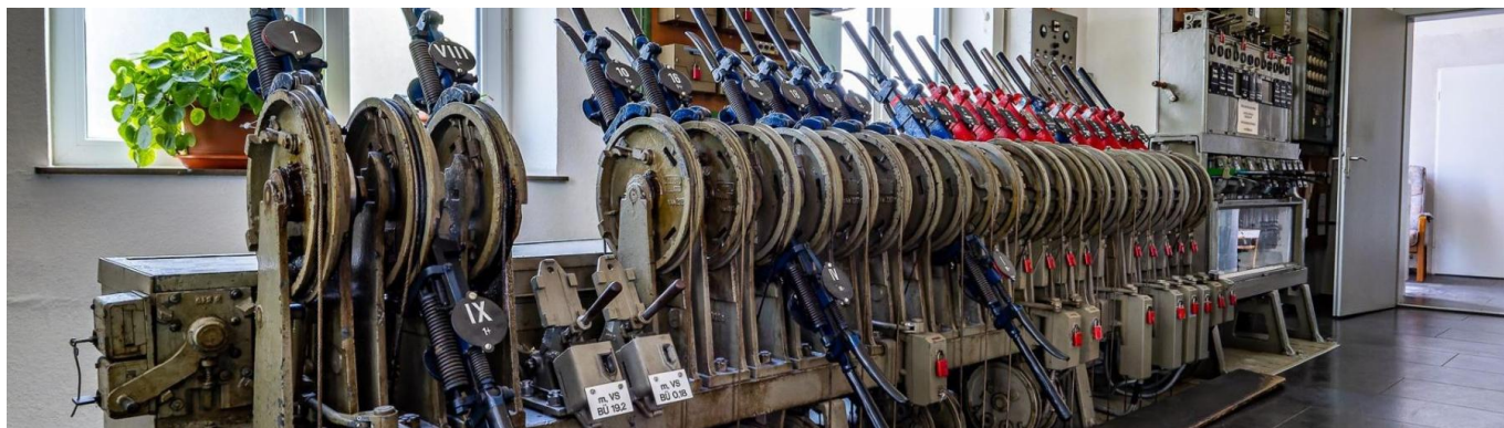
Blick auf die Stellwerkstechnik im Stellwerk Altshausen (Mai 2022) [Quelle: DB Netz AG/Thomas Ludwig]
