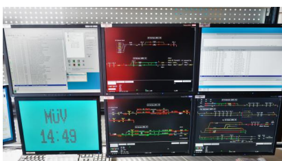
Das Elektronische Stellwerk Husum. Von hier aus wird zukünftig der Zugverkehr in Nordfriesland gesteuert (Oktober 2019) [Quelle: DB Netz AG]
