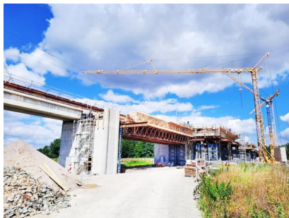
Blick auf die Bauarbeiten an der Eisenbahnüberführung „Schunter“ während der fünften Sperrpause für den Zugverkehr (August 2023) [Quelle: DB Netz AG]
