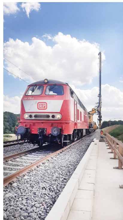
Im Juli 2023 haben wir während der fünften Sperrpause für den Zugverkehr im Bereich Klein Brunstode Rammpfahlgründungen durchgeführt (Juli 2023) [Quelle: DB Netz AG]
