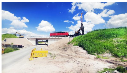
Im Juli 2023 haben wir während der fünften Sperrpause für den Zugverkehr im Bereich Klein Brunsrode Rammpfahlgründungen durchgeführt (Juli 2023) [Quelle: DB Netz AG]
