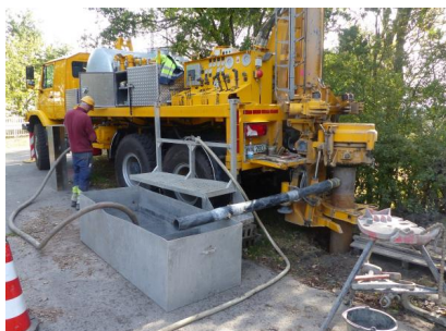
Derzeit finden zwischen Weddel und Fallersleben Baugrunduntersuchungen statt. Mit dieser Bohrmaschine können alle in der Baugrunduntersuchung anfallenden Bohrarten (Drehen, Schlagen, Bohren) durchgeführt werden. Das Hauptaugenmerk der Bohrungen liegt auf dem Gewinn von durchgängigen Bodenproben (sogenannte Bohrkerne) (September 2018) [Quelle: DB Netz AG/Maxim Faber]
