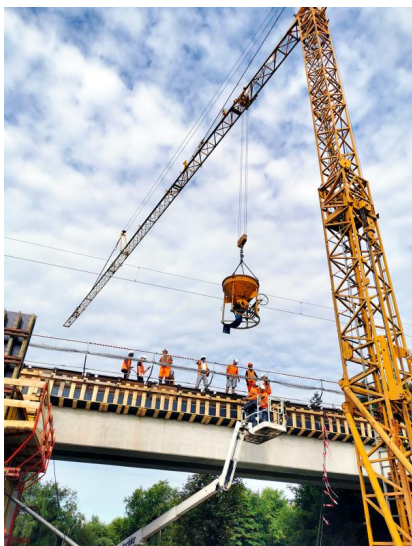
Während der Sperrpause für den Zugverkehr vom 15. bis 22. Juli 2022 wurde unter anderem ein Teilabschnitt des Kragarms an der Eisenbahnüberführung „Schunter“ betoniert (Juli 2022) [Quelle: DB Netz AG]
