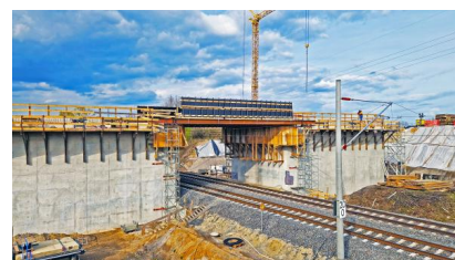
Wir haben das Brückenbauwerk der Kreisstraße 73 vollständig mit Berührungsschutz ausgestattet (März 2024) [Quelle: DB InfraGO AG/Tobias Reiff]
