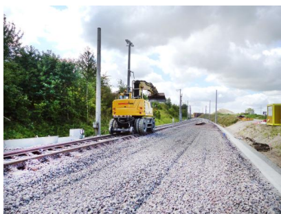
Im Streckenabschnitt neben der Landesstraße L 292 finden während der fünften Sperrpause für den Zugverkehr Bauarbeiten statt (August 2023) [Quelle: DB Netz AG]
