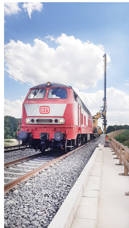
Im Juli 2023 haben wir während der fünften Sperrpause für den Zugverkehr im Bereich Klein Brunnsrode Rammpfahlgründungen durchgeführt (Juli 2023) [Quelle: DB Netz AG]
