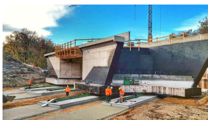
Die neue Eisenbahnbrücke über die Kreisstraße K 37 wurde während der Sperrpause für den Zugverkehr im November und Dezember 2022 eingeschoben (November 2022) [Quelle: DB Netz AG]
