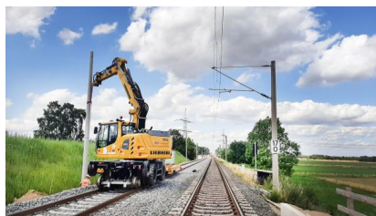
Im Juli 2023 haben wir während der fünften Sperrpause für den Zugverkehr im Bereich Klein Brunsrode Rammpfahlgründungen durchgeführt (Juli 2023) [Quelle: DB Netz AG]
