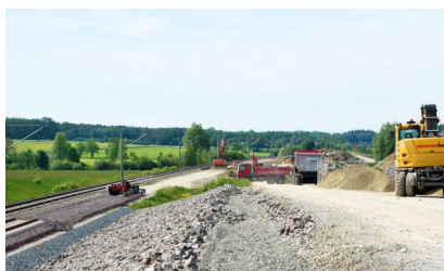
Innerhalb der Sperrpause für den Zugverkehr vom 13. bis 20. Mai 2022 haben wir beispielsweise Gründungs- bzw. Rammarbeiten durchgeführt sowie Arbeiten an der Oberleitung und am Oberbau vorgenommen (Mai 2022) [Quelle: Deutsche Bahn AG/Andreas Sahlmann]
