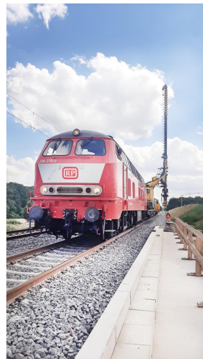
Im Juli 2023 haben wir während der fünften Sperrpause für den Zugverkehr im Bereich Klein Brunsrode Rammpfahlgründungen durchgeführt (Juli 2023) [Quelle: DB Netz AG]
