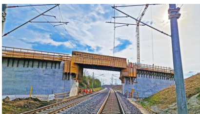
Wir haben das Brückenbauwerk auf dem Wirtschaftsweg „Fauler Feldweg“ vollständig mit Berührungsschutz ausgestattet (März 2024) [Quelle: DB InfraGO AG/Tobias Reiff]
