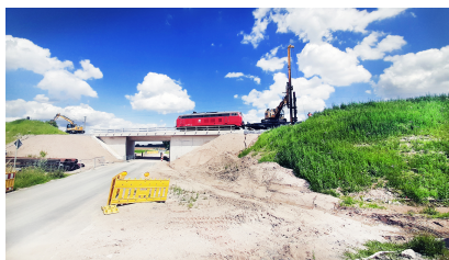
Im Juli 2023 haben wir während der fünften Sperrpause für den Zugverkehr im Bereich Klein Brunnsrode Rammpfahlgründungen durchgeführt (Juli 2023) [Quelle: DB Netz AG]
