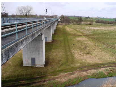
Die Schuntertalbrücke ist mit 250 Metern die längste Brücke der „Weddeler Schleife“. Sie ist derzeit für den eingleisigen Betrieb gebaut und wird im Rahmen des Projekts für die Zweigleisigkeit hergerichtet (März 2016) [Quelle: Deutsche Bahn AG/Jörg Tollkühn]
