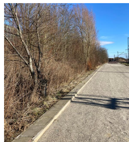
Außerhalb der Totalsperrungen werden Arbeiten zur Herstellung des Kabeltiefbaus sowie weitere bauvorbereitende Arbeiten durchgeführt, so wie hier im Bereich Weddel (Februar 2022) [Quelle: DB Netz AG/Katrin Huhs]
