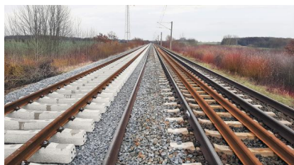
In der ersten Sperrpause für den Zugverkehr vom 29. Oktober bis 11. Dezember 2021 begannen die Hauptbauarbeiten für den zweigleisigen Ausbau der Strecke. Unter anderem wurde im Bereich Hordorf teilweise das zweite Gleis verlegt (Dezember 2021) [Quelle: DB Netz AG/Tobias Reiff]
