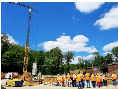
Am 16. Juni 2022 haben circa 25 Vertretende der Politik und der Verwaltung des Regionalverbands Großraum Braunschweig die Baustelle in Klein Brunnsrode besichtigt (Juni 2022) [Quelle: DB Netz AG/Lara-Tanita Rust]
