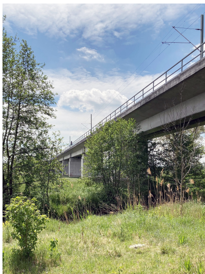
Noch verläuft die Schunterbrücke eingleisig zwischen Lehre und Groß-Brunstode. Auf der den Ortschaften zugewandten Seite ist jedoch in den nächsten Jahren eine Erweiterung für das zweite Gleis geplant. Zweigleisig fertiggestellt wird die Brücke voraussichtlich im Sommer 2023. Die Vorbereitungen für die Ausschreibung der Bauleistungen laufen derzeit bereits [Quelle: DB Netz AG/Katrin Huhs]
