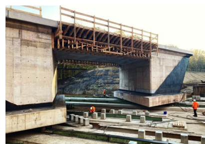
Die neue Eisenbahnbrücke über die Kreisstraße K 37 wurde während der Sperrpause für den Zugverkehr im November und Dezember 2022 eingeschoben (November 2022) [Quelle: DB Netz AG]
