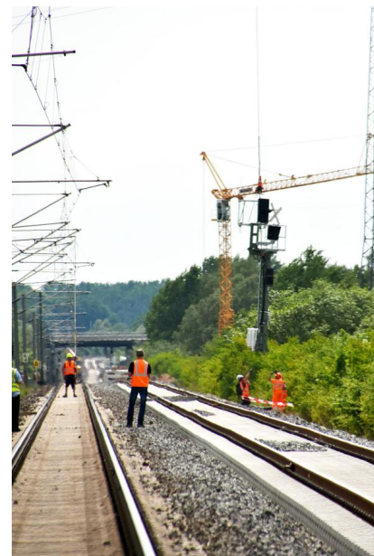
Während der Sperrpause für den Zugverkehr vom 13. bis 20. Mai 2022 haben wir unter anderem neue Signale mit einem Helikopter aufgestellt. Beim Einfliegen der Signale waren Bodenteams im Einsatz, die die Signale in Empfang genommen und befestigt haben (Mai 2022) [Quelle: Deutsche Bahn AG/Andreas Sahlmann]
