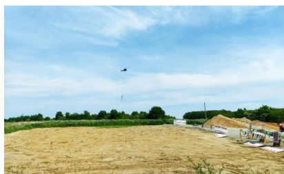
Während der Sperrpause für den Zugverkehr vom 13. bis 20. Mai 2022 haben wir unter anderem neue Signale mit einem Helikopter aufgestellt. Der Helikopter hat insgesamt 33 Signale auf einem Streckenabschnitt von circa 15 Kilometern eingeflogen (Mai 2022) [Quelle: DB Netz AG/Lara-Tanita Rust]
