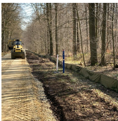
In Zusammenarbeit mit Ommo Ommen und der Ortsgruppe Lehre des Förderkreises Umwelt und Naturschutz Hondelage e.V. (FUN) wurde an der Zufahrtsstraße zur Kreisstraße K 37 ein Amphibienschutzzaun erstellt (März 2022) [Quelle: DB Netz AG/Katrin Huhs]
