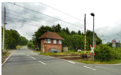
Der alte Bahnübergang „Tecklenburger Straße“ wird zu einem Trogbauwerk umgebaut (Juni 2015) [Quelle: DB Netz AG]
