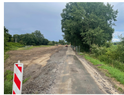
Der Bauzustand an der Straße „Am Velper Bahnhof“ (Juli 2024) [Quelle: DB InfraGO AG]
