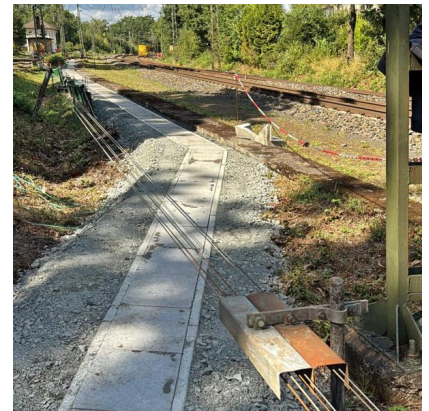
Neue Elektronische Stellwerkstechnik ersetzt das mechanische Stellwerk in Stadallendorf (August 2025) [Quelle: DB InfraGO AG]
