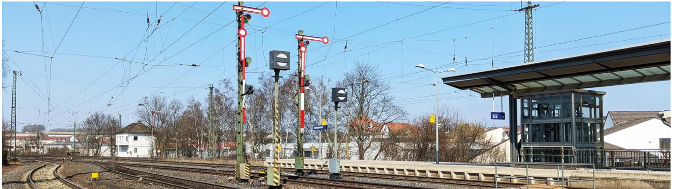
Blick auf die bestehende Signal- und Stellwerkstechnik im Bahnhof Stadtallendorf (März 2022) [Quelle: ISB Ingenieurgesellschaft für Sicherungstechnik und Bau mbH/Carsten Braune]
