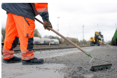
Auch die Wege zwischen den Gleisen wurden erneuert (November 2023) [Quelle: DB Netz AG]
