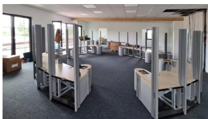
Blick auf die Plätze der Fahrdienstleiter:innen im Inneren des neuen Elektronischen Stellwerks (September 2024) [Quelle: DB InfraGO AG]
