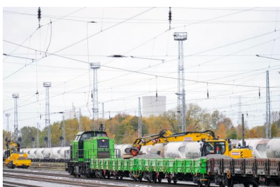
Im Rahmen der Bauphase 1.1 erneuern wir unter anderem Teile des Oberbaus (November 2023) [Quelle: DB Netz AG]
