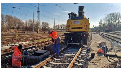
Im Rahmen der Bauphase 1.1 führen wir Arbeiten am Oberbau durch (März 2024) [Quelle: DB InfraGO AG]
