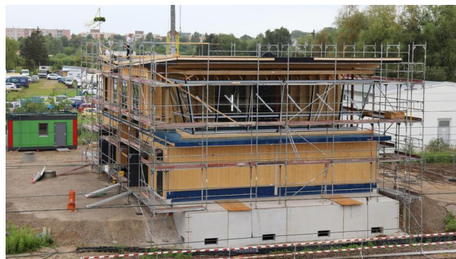
Außenansicht des neuen Elektronischen Stellwerks während der Bauarbeiten (Juli 2024) [Quelle: DB InfraGO AG]
