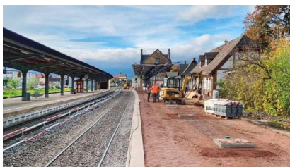
Blick auf den noch ungepflasterten Bahnsteig 1. Die Pflastersteine wurden bereits angeliefert [Quelle: DB Station&Service AG]
