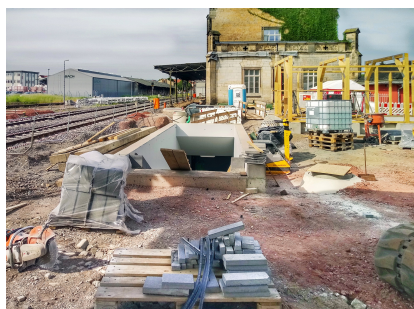
Am Bahnsteig 1 des Bahnhofs Quedlinburg wird der Zugang zur neuen Personenunterführung gebaut (Juni 2021) [Quelle: DB Station&Service AG]
