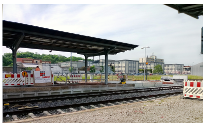
Blick auf den Bahnsteig 2/3 des Bahnhofs Quedlinburg. Hier finden derzeit Vorbereitungen für den Einbau der Aufzüge und der Treppeneinhausung statt (Juni 2021) [Quelle: DB Station&Service AG]
