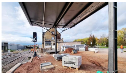
Blick auf den noch ungepflasterten Bahnsteig 1. Die Pflastersteine wurden bereits angeliefert [Quelle: DB Station&Service AG]
