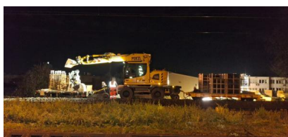
Arbeiten zum Bau der Mehrgleisausleger (Dezember 2025) [Quelle: DB InfraGO AG/Wulliam Tchoumy Sandjong]
