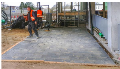
Blick auf die Pflasterarbeiten am Vorplatz Nord des Bahnhofs Pinneberg (März 2021) [Quelle: DB Station&Service AG]
