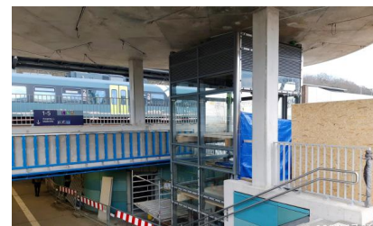
Die Aufzugsschächte im Bahnhof Pinneberg wurden fertiggestellt. Die Inbetriebnahme der Aufzüge ist für Ende Mai 2021 geplant (März 2021) [Quelle: DB Station&Service AG]
