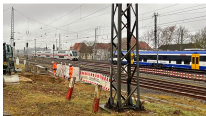
Der Zugbetrieb wird während unserer Bauarbeiten größtenteils aufrechterhalten (April 2025) [Quelle: DB InfraGO AG]
