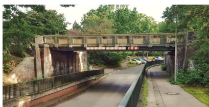
Blick auf die zu erneuernde S-Bahn-Brücke „Sodenkamp“ (Juli 2021) [Quelle: DB Netz AG]
