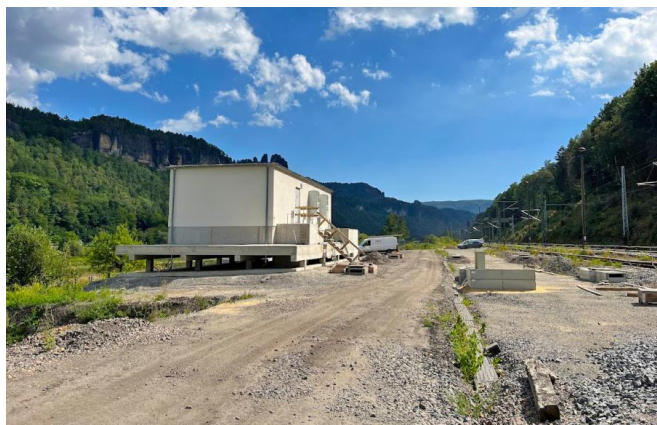
Das Modulgebäude, das ESTW-A Bad Schandau Ost, wurde errichtet (August 2023) [Quelle: DB Netz AG]
