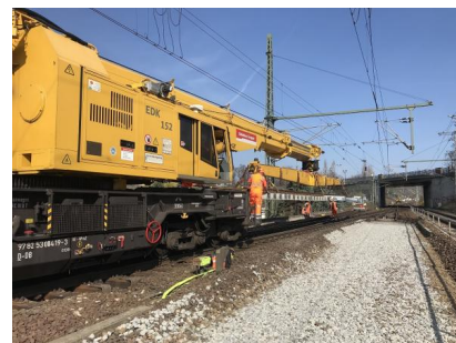
Das erste Gleisstück wird auf dem vorbereiteten Untergrund abgelegt [Quelle: DB Engineering & Consulting/Andrey Kurygin]
