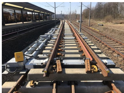
Eine der neun modernen Weichen rund um den Bahnhof Pirna (März 2019) [Quelle: DB Engineering & Consulting/Andrey Kurygin]
