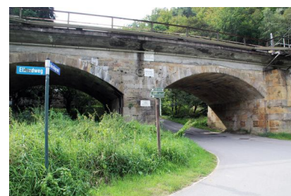
Das Hirschmühlenviadukt vor dem Einbau der neuen Fahrbahnwanne (1) (August 2016) [Quelle: DB Netz AG/Steffen Burkhardt]
