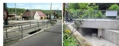
Die neu gebaute Grabenbrücke „Telschgraben“ (Haltepunkt Wehlen) wurde 2016 fertiggestellt (2017) [Quelle: DB Netz AG]
