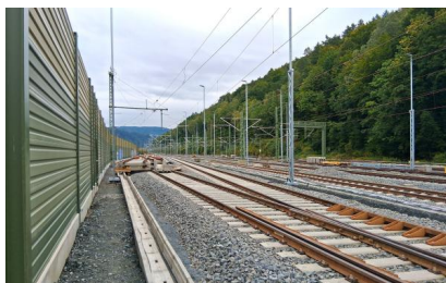
Blick auf die neue Gleisfeldbeleuchtung am Güterbahnhof Bad Schandau Ost (September 2025) [Quelle: DB InfraGO AG]
