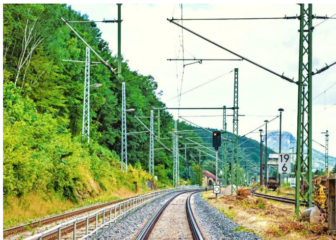
Bei genauerer Betrachtung der Oberleitung fällt auf, dass der Fahrdraht über dem Gleis von Mast zu Mast hin und her schwenkt. Der „Zick-Zack“ ergibt sich durch die wechselnde Bauform der Oberleitungsausleger (August 2022 [Quelle: DB Netz AG/ Jörn Daberkow])
