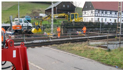
Im Kurort Rathen wird der Oberbau erneuert (November 2019) (2) [Quelle: DB Netz AG/Albrecht Neumann]
