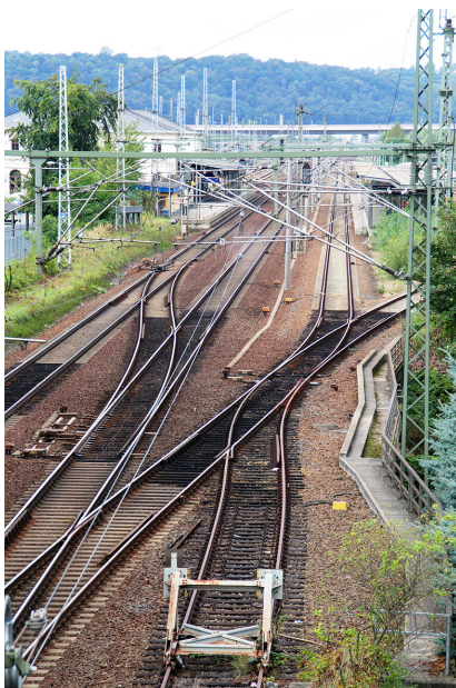
Die abgebildeten Weichen im Bahnhof Pirna werden voraussichtlich 2019 umgebaut (August 2016) [Quelle: DB Netz AG/Steffen Burkhardt]
