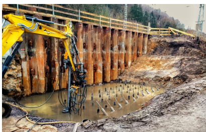
Die Eisenbahnüberführung am Güterbahnhof Bad Schandau Ost wird auf Mikropfählen gegründet (Februar 2023) [Quelle: DB Netz AG]
