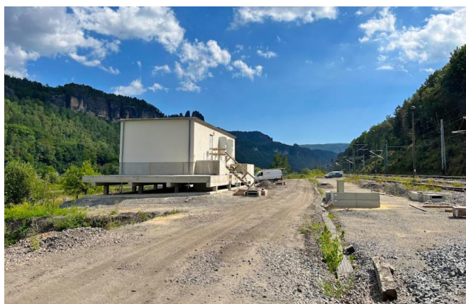
Das Modulgebäude, das ESTW-A Bad Schandau Ost, wurde errichtet (August 2023) [Quelle: DB Netz AG]
