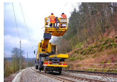
In zwei Bauphasen von Juni 2022 bis Februar 2023 erneuern wir die Oberleitungsanlage von der Grenze D/CZ bis zum Bahnhof Schöna (Juni 2022) [Quelle: DB Netz AG]
