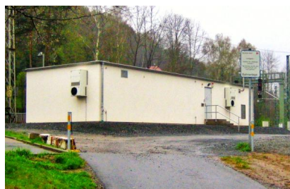
Blick auf das Modulgebäude eines Elektronischen Stellwerks (April 2011) [Quelle: DB Netz AG]
