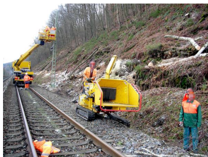
Von November 2014 bis März 2015 sowie von November 2015 bis März 2016 wurde die Oberleitung im Abschnitt zwischen Königstein und Bad Schandau erneuert [Quelle: DB Netz AG]
