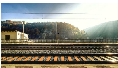
Unter anderem wurden im Bahnhof Schöna Schienen, Schwellen und Schotter erneuert (Oktober 2021) [Quelle: DB Netz AG/Jörn Daberkow]
