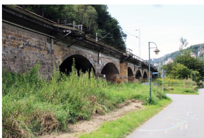
Das Hirschmühlenviadukt vor dem Einbau der neuen Fahrbahnwanne (2) (August 2016) [Quelle: DB Netz AG/Steffen Burkhardt]
