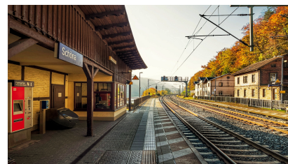
Der erneuerte Oberbau im Bahnhof Schöna (Oktober 2021) [Quelle: DB Netz AG/Jörn Daberkow]
