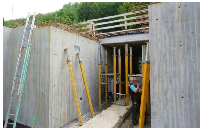
Blick auf den Baufortschritt an der Eisenbahnüberführung im Güterbahnhof Bad Schandau Ost (Mai 2023) [Quelle: DB Netz AG]
