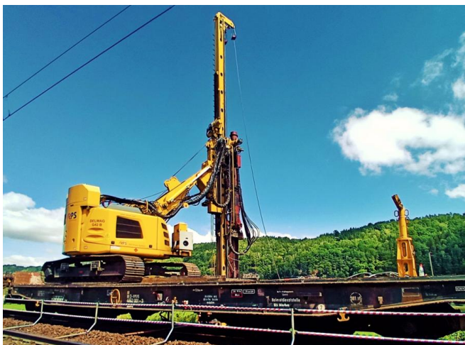
Auf der Strecke vom Bahnhof Schöna bis zum Bahnhof Bad Schandau Ost wird die Oberleitung erneuert (Juli 2022) [Quelle: DB Netz AG]
