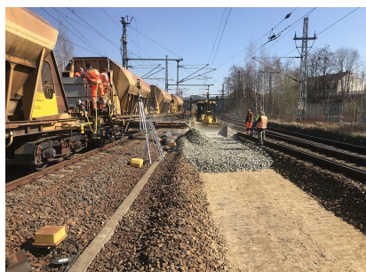
Der Untergrund für die neuen Weichen im Bereich des Bahnhofs Pirna wird vorbereitet (März 2019) [Quelle: DB Engineering & Consulting/Andrey Kurygin]
