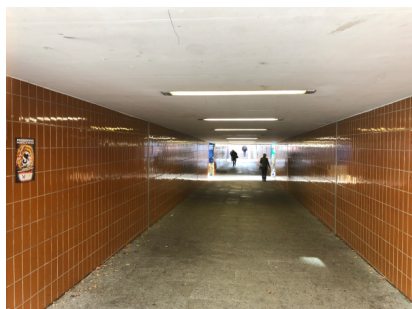
Die Personenunterführung verbindet die Bahnhofstraße mit der Plochinger Straße sowie mit der Neuffener Straße (November 2018) [Quelle: DB Netz AG/Mark Jahns]
