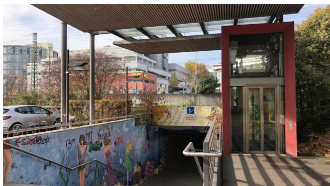
Wir erneuern altersbedingt die Eisenbahnüberführung und die darunter liegende Personenunterführung südlich des Bahnhofs Nürtingen (November 2018) [Quelle: DB Netz AG/Mark Jahns]
