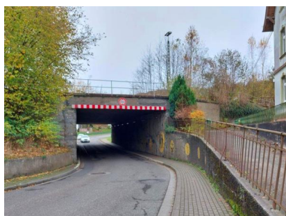
Die Brücke erreicht das Ende ihrer technischen Nutzungsdauer und wird durch einen Neubau ersetzt (November 2024) [Quelle: DB InfraGO AG]
