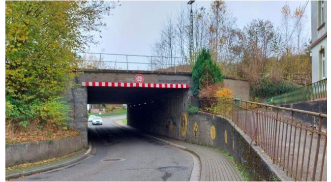
Die Brücke erreicht das Ende ihrer technischen Nutzungsdauer und wird durch einen Neubau ersetzt (November 2024) [Quelle: DB InfraGO AG]
