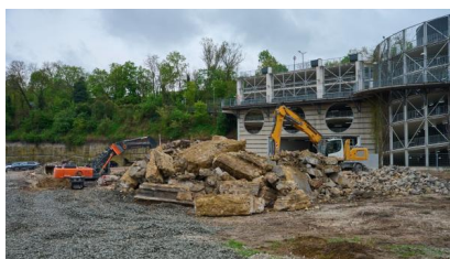
Rückbau des alten Bahnbetriebswerks für die künftige Digitale Steuerzentrale (April 2025) [Quelle: DB InfraGO AG/Stefan Wildhirt]
