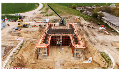
Blick auf das Fundament der künftigen Eisenbahnüberführung bei Gallentin (April 2026) [Quelle: HTG Projektmanagement GmbH]
