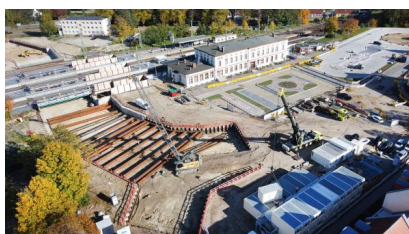
Blick auf die fertiggestellte Baugrubenumschließung an der Südseite. Ebenfalls zu erkennen ist die Baustelle der Stadt am Zentralen Omnibusbahnhof (Oktober 2022) [Quelle: DB Netz AG]
