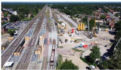
Die Sonderkonstruktion für die Weiche 15 wurde fertiggestellt (Juni 2022) [Quelle: DB Netz AG]
