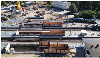
Blick auf die Sonderkonstruktion für die Weiche 15. Diese wurde bis Ende Mai 2022 fertiggestellt (Juni 2022) [Quelle: DB Netz AG]
