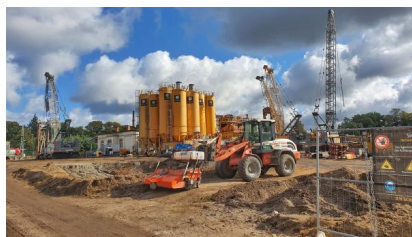
Blick auf die Baustelleneinrichtung und Säulen, die das Bentonit zur Herstellung der Schlitzwände beinhalten (Oktober 2021) [Quelle: DB Netz AG]
