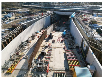
Blick auf den Baufortschritt in Richtung des Troges (Februar 2025) [Quelle: DB InfraGO AG]
