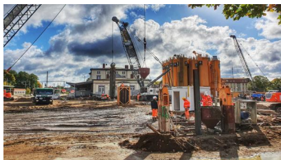
Ein Schlitzwandbagger steht in dem Umbaubereich, wo später die Straßenerüberführung entsteht (Oktober 2021) [Quelle: DB Netz AG]
