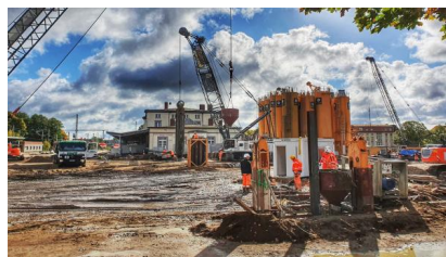
Ein Schlitzwandbagger steht in dem Umbaubereich, wo später die Straßenunterführung entsteht (Oktober 2021) [Quelle: DB Netz AG]
