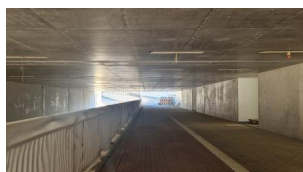
Blick auf den Fußweg im neuen Trogbauwerk (September 2025) [Quelle: DB InfraGO AG]
