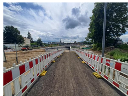
Der provisorische Weg durch die Eisenbahnüberführung ist für Fußgehende und Radfahrende frei (August 2025) [Quelle: DB InfraGO AG]
