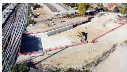
Die Baugrubenumschließung an der Nordseite wurde fertiggestellt (Oktober 2022) [Quelle: DB Netz AG]
