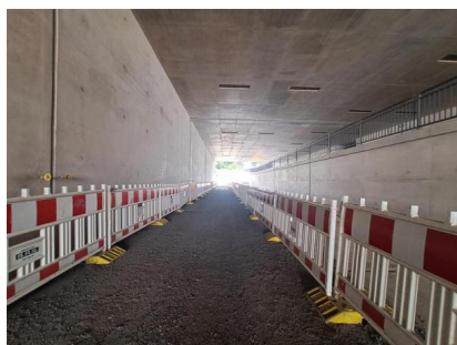
Der provisorische Weg durch die Eisenbahnüberführung ist für Fußgehende und Radfahrende frei (August 2025) [Quelle: DB InfraGO AG]
