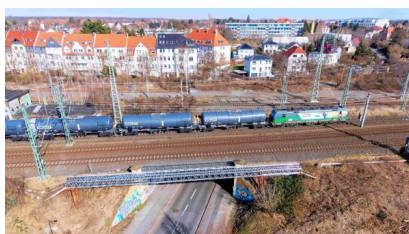
Die Eisenbahnbrücke über die Pittlerstraße vor Beginn der Bauarbeiten (Februar 2026) [Quelle: DB InfraGO AG/Jürgen Findeisen]
