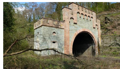
Es ist geplant, entlang der Lahntalbahn sechs Tunnel zu erneuern [Quelle: DB Netz AG]
