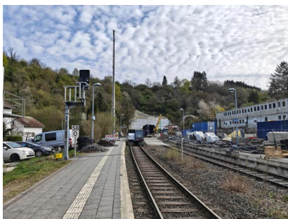
Während der abschließenden Sperrpause für den Zugverkehr von April bis Mai 2026 stellen wir am Fachinger Tunnel das neue Tunnelportal her und bauen den Behelfsbahnsteig sowie die Bauweiche vor dem Tunnelportal zurück (April 2026) [Quelle: DB InfraGO AG]
