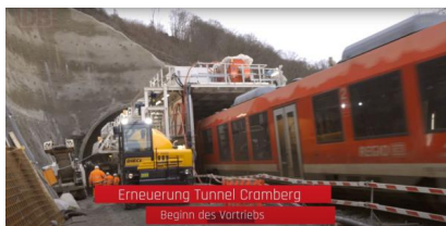
YouTube: Beginn der Aufweitung des Cramberger Tunnels (Juli 2024) [Quelle: DB InfraGO AG]
