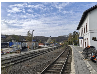
Während der abschließenden Sperrpause für den Zugverkehr von April bis Mai 2026 stellen wir am Fachinger Tunnel das neue Tunnelportal her und bauen den Behelfsbahnsteig sowie die Bauweiche vor dem Tunnelportal zurück (April 2026) [Quelle: DB InfraGO AG]
