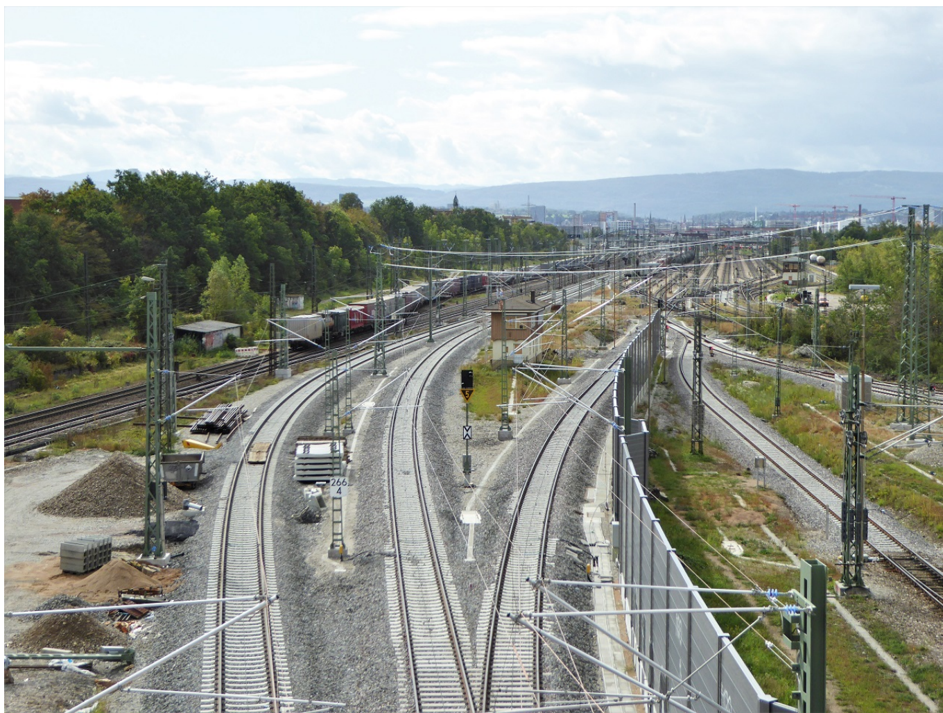
Die neue westliche Gleistrasse zwischen Haltingen und Weil am Rhein, Blick in Richtung Basel (September 2019) [Quelle: Elmar Kiefer]
