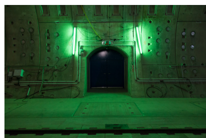
Rettungsschleusen wie diese verbinden die benachbarten Tunnelröhren miteinander [Quelle: Deutsche Bahn AG]
