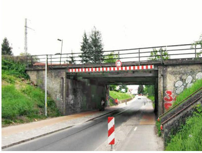
Die Eisenbahnüberführung hat das Ende ihrer technischen Nutzungsdauer erreicht und wird erneuert [Quelle: DB Netz AG]
