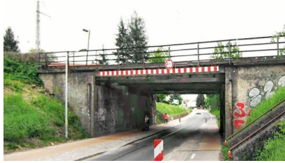
Die Eisenbahnüberführung hat das Ende ihrer technischen Nutzungsdauer erreicht und wird erneuert [Quelle: DB Netz AG]
