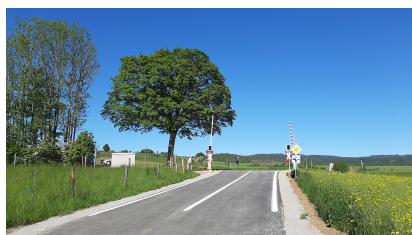
Bis Mai 2021 wurden mehrere Bahnübergänge im Ortsteil Gittelde der Gemeinde Bad Grund (Harz) bereits wieder in Betrieb genommen (Mai 2021) [Quelle: DB Netz AG]
