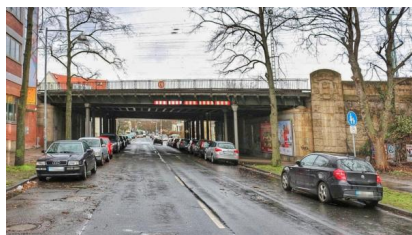
Blick auf die Eisenbahnbrücke. Sie erreicht das Ende ihrer technischen Nutzungsdauer (März 2015) [Quelle: DB Netz AG]
