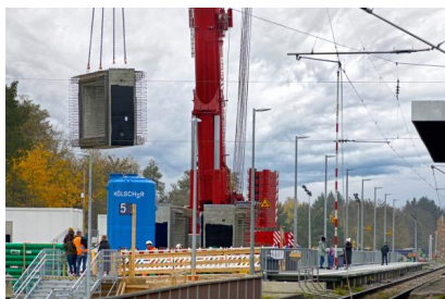
Einhub der Fertigteile der neuen Personenunterführung während des barrierefreien Ausbaus (November 2025) [Quelle: Deutsche Bahn AG/Christian Bedeschinski]
