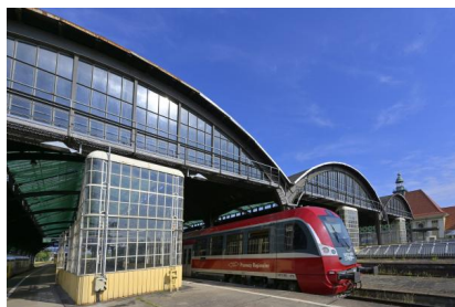
Die Sanierung der Bahnsteighalle wird von Schiff zu Schiff durchgeführt. Voraussichtlich ab März 2023 wird der Gerüstaufbau und die Einhausung der Stahlkonstruktion am Bahnsteig 11/12 beginnen (2021) [Quelle: Deutsche Bahn AG/C. Bedeschinski]
