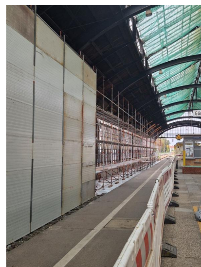
Die Südseite der Bahnsteighalle wird für die späteren Sandstrahlarbeiten eingehüllt (Juli 2025) [Quelle: Deutsche Bahn AG/Andreas Bach]
