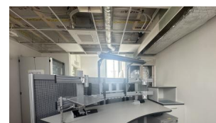
Damit wir das Brückenwärterhaus betriebsbereit machen können, wurden die Bedientische für den Brückenwärter und den Fahrdienstleiter geliefert (Juni 2024) [Quelle: DB InfraGO AG]
