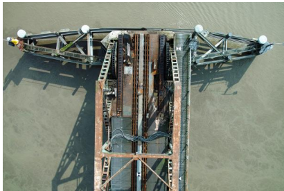
Brückenpfeiler nach dem Unfall [Quelle: Ingenieurbüro Drecoll]
