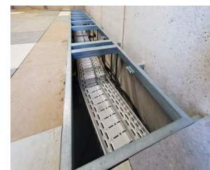
Blick auf den Doppelboden und auf einen Teil des Kabelführungssystems der Netzstation (Februar 2024) [Quelle: DB InfraGO AG]
