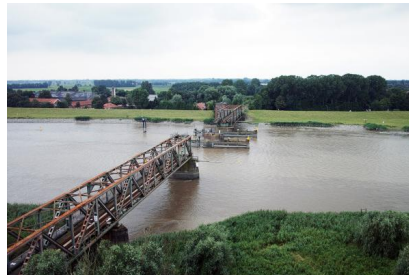
Blick auf die zerstörte Friesenbrücke [Quelle: Ingenieurbüro Drecoll]
