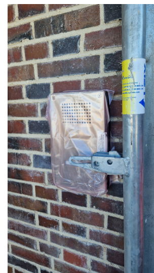
Gegensprechanlage für die Sicherheit (März 2025) [Quelle: DB InfraGO AG]
