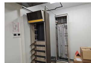
Für das ESTW wurden die ersten Telekommunikations- und Leit- und Sicherungstechnik-Schränke angeliefert (Juni 2025) [Quelle: DB InfraGO AG]
