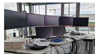
Wir haben die Bedientische im Brückenwärterhaus für den Brückenwärter und den Fahrdienstleiter mit Monitoren ausgestattet (Juli 2024) [Quelle: DB InfraGO AG]
