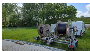
Die Signalübertragungskabel (Mai 2025) [Quelle: DB InfraGO AG]
