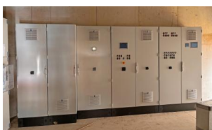
Wir haben die Schaltschränke für die Steuerung der Brücke installiert (August 2024) [Quelle: DB InfraGO AG]
