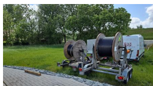
Die Signalübertragungskabel (Mai 2025) [Quelle: DB InfraGO AG]
