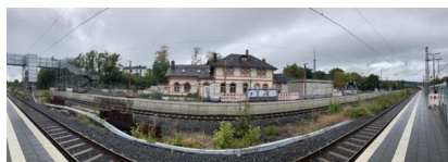
Blick auf den Hausbahnsteig mit Verbau zur Sicherung der Gleise zwischen den Gleisen 402 und 404 (September 2024) [Quelle: DB InfraGO AG]
