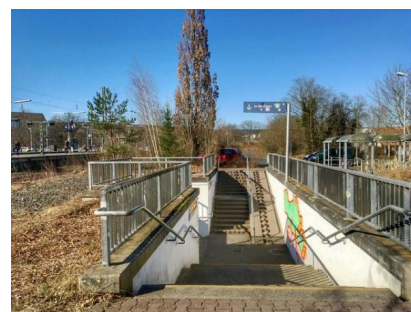
Um Einschränkungen im Zugverkehr zu vermeiden, errichten wir zunächst eine provisorische Personenüberführung (März 2022) [Quelle: DB Station&Service AG]
