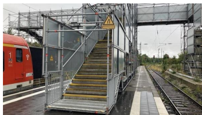
Aufgang zur provisorischen Personenüberführung – diese dient als Stadtteilverbindung (September 2024) [Quelle: DB InfraGO AG]
