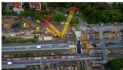
Blick auf den Einhub der neuen Personenunterführung (Juli 2025) [Quelle: DB InfraGO AG]
