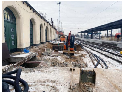
Durch starken Frost gab es im Februar 2021 einen Baustillstand (Februar 2021) [Quelle: DB Station&Service AG]
