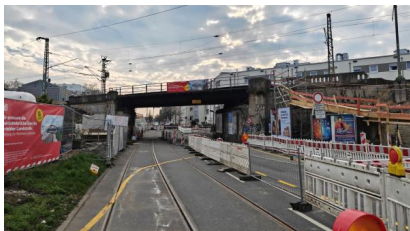
Seit März 2026 ist die Mörfelder Landstraße für alle Verkehrsteilnehmenden gesperrt, nur noch die Feuerwehr darf die Baustelle passieren (März 2026) [Quelle: DB InfraGO AG]
