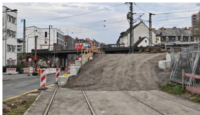
Der Standplatz des Schwerlastkrans wird durch eine Stützwand abgesichert (März 2026) [Quelle: DB InfraGO AG]
