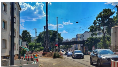
Vorbereitende Arbeiten zum Umverlegen der Leitungen im Umfeld der Eisenbahnüberführung (Juli 2025) [Quelle: DB InfraGO AG]
