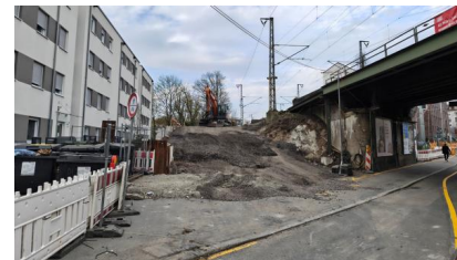
Über eine aufgeschüttete Rampe gelangen Baufahrzeuge auf den Bahndamm (März 2026) [Quelle: DB InfraGO AG]
