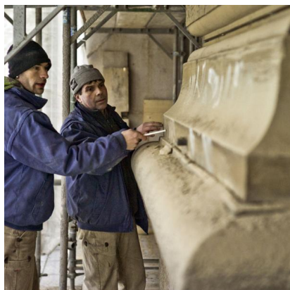
Begutachtung und Vermessen der schadhaften Stellen in der Natursteinfassade [Quelle: BHP, Heidelberg]
