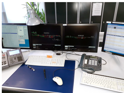
Mithilfe der Elektronischen Stellwerkstechnik (ESTW-Technik) können Weichen und Signale im Bahnhof Fichtenberg künftig in Sekundenschnelle gestellt werden (November 2019) [Quelle: Symbolbild, DB Netz AG]
