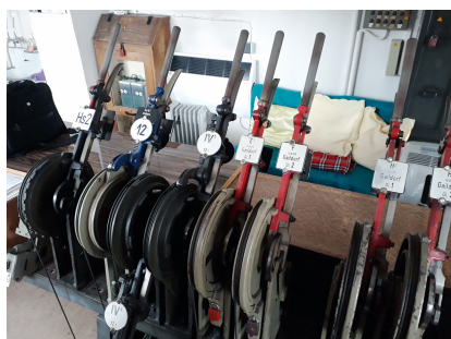
Die vorhandenen mechanischen Stellwerke im Bahnhof Fichtenberg entsprechen nicht mehr den modernen technischen und betrieblichen Anforderungen des Eisenbahnverkehrs (November 2017) [Quelle: DB Netz AG]
