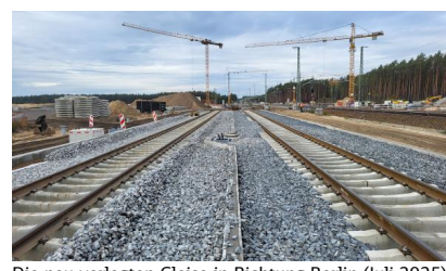
Die neu verlegten Gleise in Richtung Berlin (Juli 2025) [Quelle: DB InfraGO AG]
