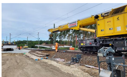
Mit einem großen Eisenbahndrehkran wird ein vormontiertes Weichenteil zum Bahnhof gebracht und dort eingebaut (Juli 2025) [Quelle: DB InfraGO AG]
