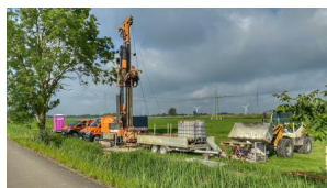
Wir führen Bohrungen zum Erstellen von Grundwassermessstellen durch (Juni 2024) [Quelle: DB InfraGO AG]
