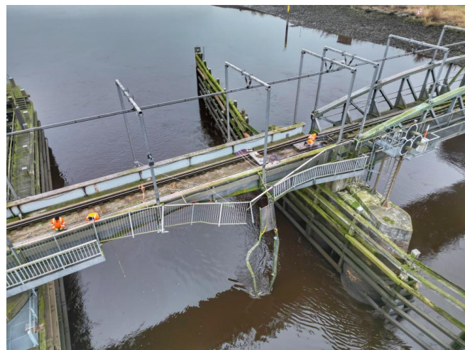
Blick auf die beschädigte Brücke nach dem Schiffsanprall (Februar 2024) [Quelle: DB InfraGO AG]
