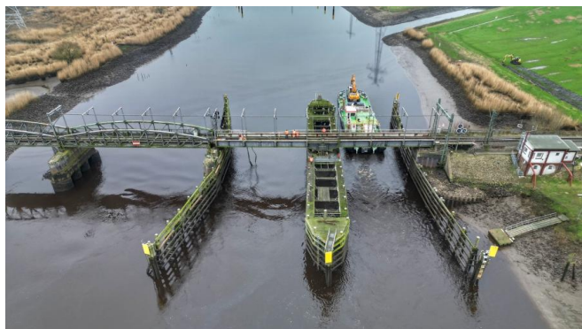
Blick auf die beschädigte Brücke nach dem Schiffsanprall (Februar 2024) [Quelle: DB InfraGO AG]
