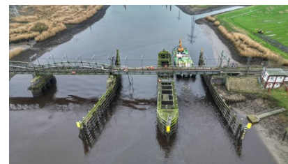
Blick auf die beschädigte Brücke nach dem Schiffsanprall (Februar 2024) [Quelle: DB InfraGO AG]
