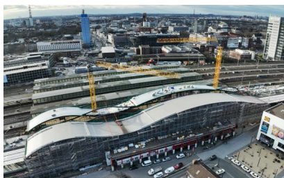
Blick auf den Baufortschritt aus der Vogelperspektive (März 2024) [Quelle: DB InfraGO AG]
