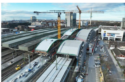
Blick auf den Baufortschritt aus der Vogelperspektive (März 2024) [Quelle: DB InfraGO AG]
