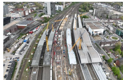
Die Arbeiten am Dach sowie an den Bahnsteigen 3 (Gleise 5/6) und 4 (Gleise 8/9) schreiten voran (April 2025) [Quelle: DB InfraGO AG]
