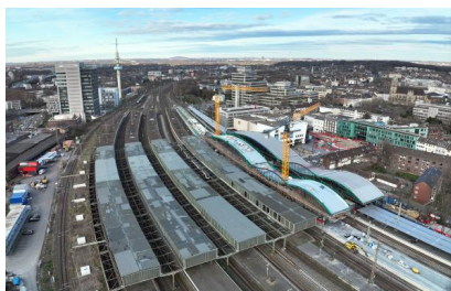
Die Arbeiten am Dach des Bahnsteigs 5 haben wir weitestgehend abgeschlossen (März 2024) [Quelle: DB InfraGO AG]
