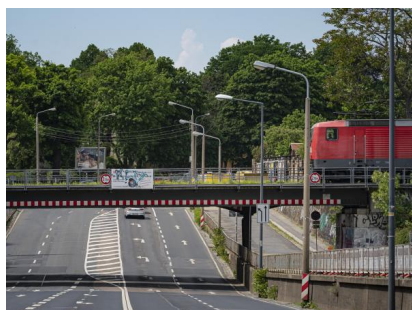
Ein Zug fährt über die Eisenbahnbrücke über die Stauffenbergallee (Juni 2021) [Quelle: DB InfraGO AG/Jörn Daberkow]
