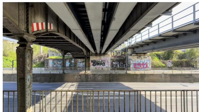
Die Unterseite der Eisenbahnbrücke über die Stauffenbergallee (April 2023) [Quelle: DB InfraGO AG/Jörn Daberkow]
