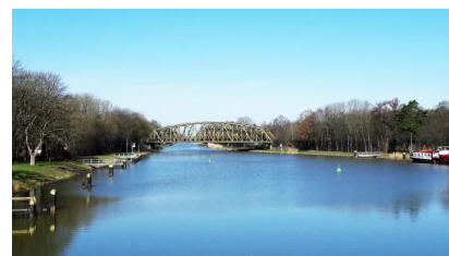
Die Eisenbahnüberführung über den Dortmund-Ems-Kanal muss erneuert werden. Hierbei wird außerdem die Durchfahrthöhe für Schiffe um 1,4 Meter vergrößert (April 2018) [Quelle: DB Netz AG/Raffaela Cannizzo]
