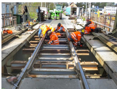
Wir führen die jährlichen Inspektions- und Instandhaltungsarbeiten durch (April 2022) [Quelle: DB Netz AG]
