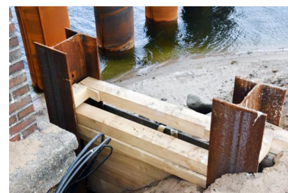
Zwischen die bestehenden Brückenpfeiler auf der Südseite wurden sogenannte Hilfsabfangungen gebaut (März 2021) [Quelle: Deutsche Bahn AG]
