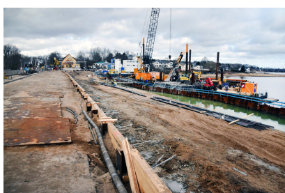
An der Schleibrücke Lindaunis wird sowohl vom Land als auch vom Wasser aus gearbeitet (März 2021) [Quelle: Deutsche Bahn AG]
