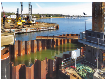
Blick auf die Vorbereitungsarbeiten für die Aussteifung der Baugrube von Pfeiler 3 (April 2022) [Quelle: DB Netz AG]
