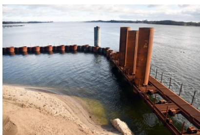
Zwischen die bestehenden Brückenpfeiler auf der Südseite wurden sogenannte Hilfsabfangungen gebaut (März 2021) [Quelle: Deutsche Bahn AG]
