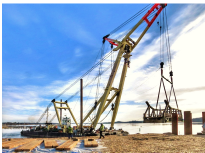
Wir haben das bewegliche Klappteil der Brücke ausgehoben (April 2023) [Quelle: DB Netz AG/Lars Kalweit]
