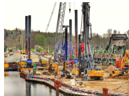
Blick auf die Herstellung der geotextilmantelten Sandsäulen, die Vorbereitungsarbeiten für die Aussteifung der Baugrube von Pfeiler 3 sowie auf die Deckwerksherstellung vom Damm Süd (April 2022) [Quelle: DB Netz AG]
