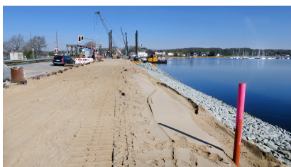
Der Damm Süd mit Messpegel wird hergestellt (April 2022) [Quelle: DB Netz AG]
