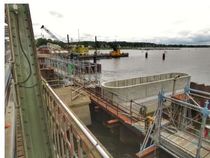
Wir haben den Rohbau des Pfeilers 1 fertiggestellt (November 2023) [Quelle: DB Netz AG]
