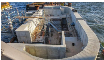
Der Pfeiler 3 wurde so weit fertiggestellt, dass er für die Arbeiten am Stahlüberbau bereit ist (Februar 2025) [Quelle: DB InfraGO AG/Lars Kalweit]
