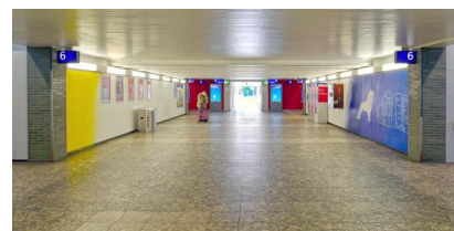
Die Personenunterführung des Hauptbahnhofs Braunschweig vor der Modernisierung (Mai 2020) [Quelle: DB Netz AG/Christian Bedeschinski]
