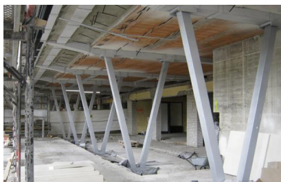
Die sogenannten V-Stützen stabilisieren das Dach der Zooterrassen (Mai 2016) [Quelle: DB Station&Service AG]
