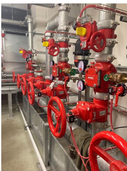
Blick auf die Sprinkleranlage, welche im Bauabschnitt 1 fertiggestellt wurde (Januar 2026) [Quelle: DB InfraGO AG]
