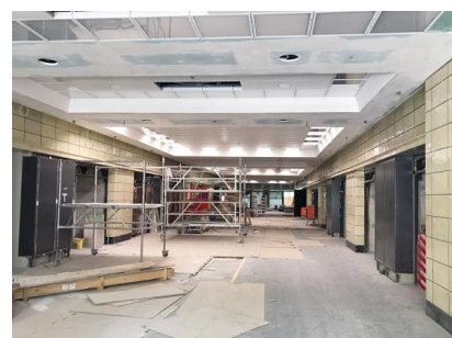
Derzeit finden Arbeiten an den Erdgeschossflächen im Empfangsgebäude statt (Juli 2020) (1) [Quelle: DB Station&Service AG]
