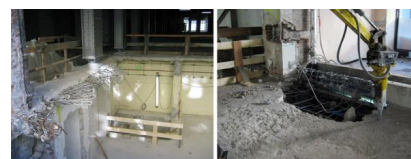
In der Lüfterzentrale wird die Decke zurückgebaut (September 2017) [Quelle: DB Station&Service AG]
