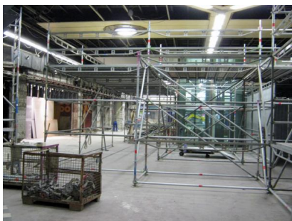
In der Fernbahnhalle laufen die Arbeiten auf Hochtouren (3) (Oktober 2018) [Quelle: DB Station&Service AG]
