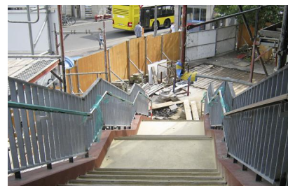
Im Rahmen der Modernisierung der Zooterrassen wird auch an der bestehenden Treppe gearbeitet (Mai 2016) [Quelle: DB Station&Service AG]
