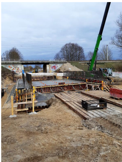
In Neustrelitz fanden Arbeiten zur Erneuerung der Eisenbahnüberführung „Wesenberger Chaussee“ statt (April 2021) [Quelle: DB Netz AG]
