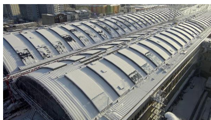
Blick auf das mit Schnee bedeckte Dach. Die Oberlichtmontage ist nahezu abgeschlossen (Februar 2025) [Quelle: DB InfraGO AG]
