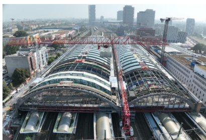
Luftaufnahme mit Blick nach Osten (September 2024) [Quelle: DB Engineering & Consulting GmbH/Marius Müller]
