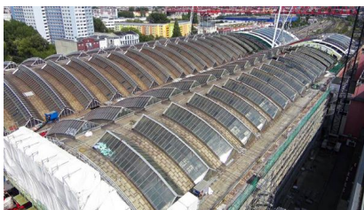
Blick auf den Baufortschritt an den Gleishallendächern (Juli 2023) [Quelle: DB Station&Service AG]
