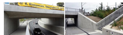
Am 5. September 2016 wurde die neue Straßenunterführung in Dahlewitz für den Verkehr freigegeben [Quelle: DB Netz AG]
