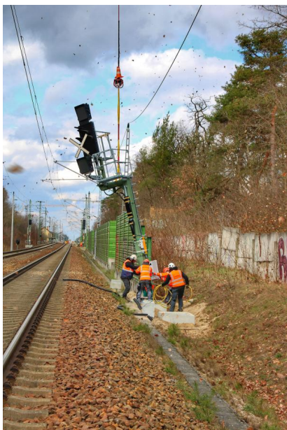
Das Aufstellen weiterer Signale in Wünsdorf-Waldstadt folgte bis zum 7. März 2022 (März 2021) [Quelle: DB Netz AG]
