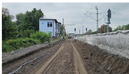
Blick auf den Fortschritt der Arbeiten für den Neubau von Gleis 2 am Bahnhof Zossen (August 2025) [Quelle: PUS GmbH]
