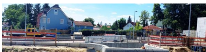
Die Restarbeiten an der Rampe im Bahnhof Wünsdorf-Waldstadt, wie beispielsweise die Montage des Geländers und der Anschluss an den Bahnhofsvorplatz auf der Westseite, werden sukzessive weitergeführt (Juni 2022) [Quelle: DB Netz AG]
