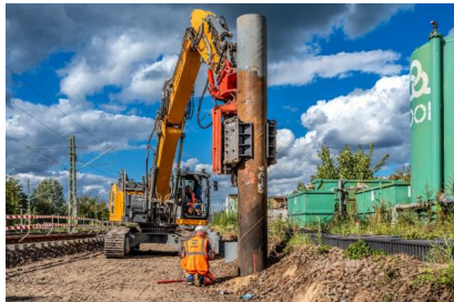
Einbringen eines Gründungsrohrs für die Schallschutzwand am Bahnhof Zossen (September 2025) [Quelle: PUS GmbH]
