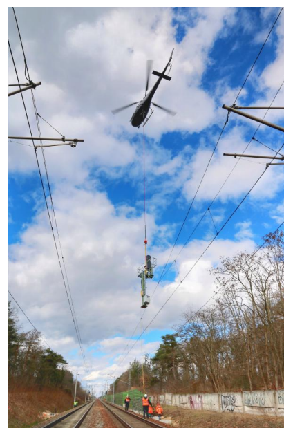
Am Bahnhof Wünsdorf-Waldstadt haben wir Signale mittels Helikopter gesetzt (März 2021) [Quelle: DB Netz AG]
