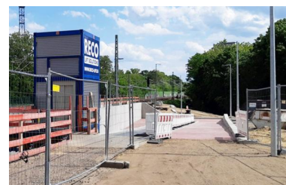
Die Rampe im Bahnhof Wünsdorf-Waldstadt kann seit dem 31. Mai 2022 befahren werden. Der bauzeitliche Personenaufzug wurde entfernt (Mai 2022) [Quelle: DB Netz AG]
