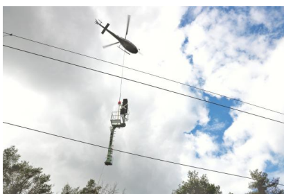
Die Signale wurden mittels Helikopter in Wünsdorf-Waldstadt aufgestellt (März 2021) (März 2021) [Quelle: DB Netz AG]
