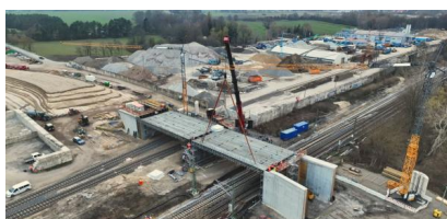
YouTube: Einhub der Brückenelemente für die Straßenüberführung der Bundesstraße B 246 in Zossen (März 2024) [Quelle: DB InfraGO AG]
