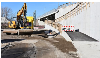
An der neuen Straßenüberführung der Bundesstraße B 246n in Zossen errichten wir eine Rampe (März 2025) [Quelle: PUS GmbH]
