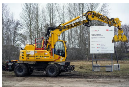
Am 30. November 2021 fand der offizielle Spatenstich für den Ausbau der Strecke statt (November 2021) [Quelle: Deutsche Bahn AG/Volker Emersleben]
