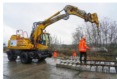
Am 30. November 2021 wurde mit dem Ausbau des 1. Bauabschnitts Angermünde – Passow begonnen (November 2021) [Quelle: Deutsche Bahn AG/Volker Emersleben]
