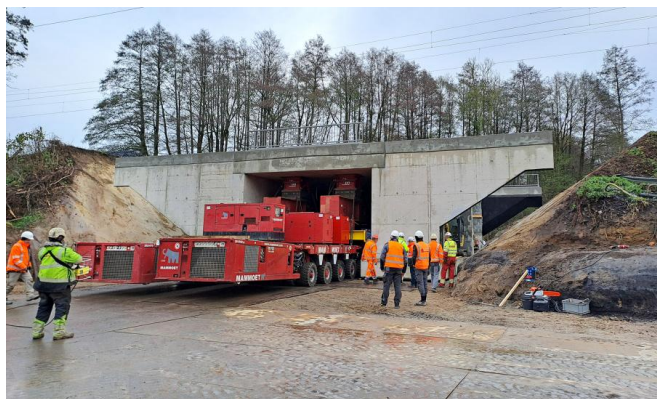
Die neue Stahlbetonrahmenbrücke wurde am 15. November 2025 mit Hilfe eines Schwerlasttransporters eingefahren (November 2025) [Quelle: DB InfraGO AG]
