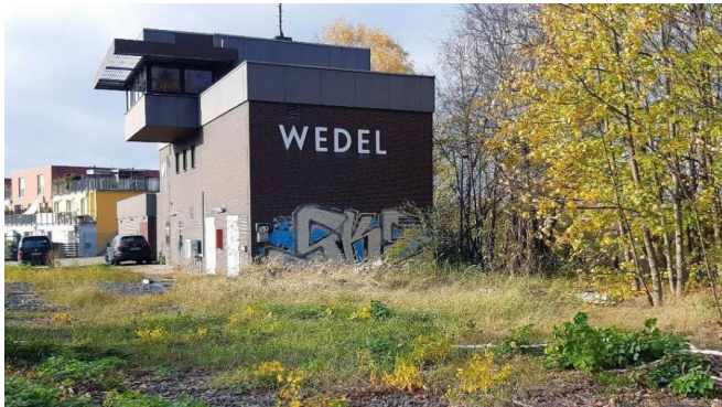
Blick auf die Stromversorgungsstation mit Gleichrichterwerk in Wedel (November 2021) [Quelle: DB Energie GmbH]
