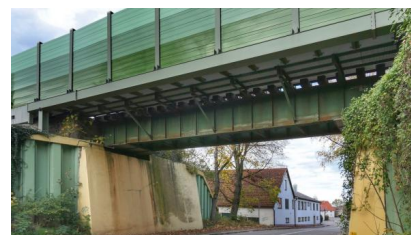
Wir erweitern die eingleisige Eisenbahnüberführung „Hauptstraße“ in Buxheim um ein zweites Gleis (November 2022) [Quelle: DB Netz AG/Michael Waag]
