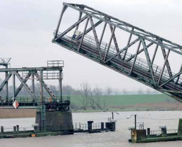
Die Friesenbrücke vor dem Unfall (November 2015)
