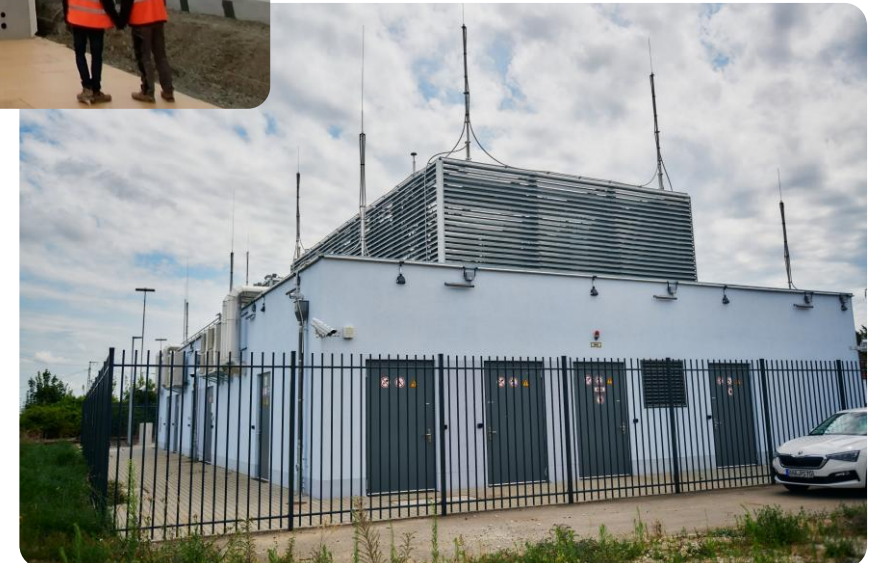
DTZ des DSTW Donauwörth Quelle: Deutsche Bahn AG / Dominic Dupont
