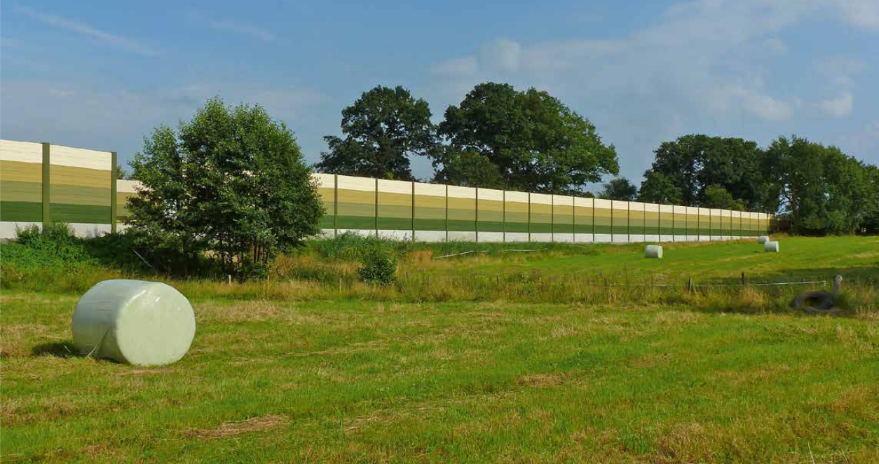
Im Planfeststellungsabschnitt 1 werden rund 15.800 Meter Schallschutzwände gebaut. Das Bild zeigt eine umgesetzte Maßnahme im Bereich Bereich Rastede.
