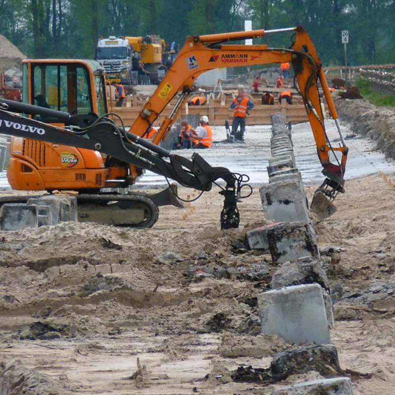
Fahrtwegtiefundung zwischen Jaderberg und Varel: Vorbereitende Arbeiten für das Gießen der Stahlbetonplatte und ...
